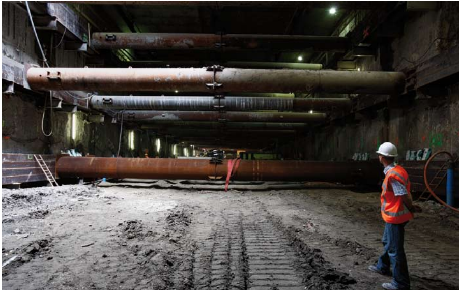
Na de lekkage en verzakking op 10 september liggen de graafwerkzaamheden in station Vijzelgracht stil voor onderzoek.
