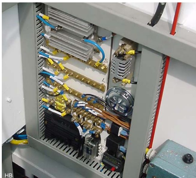
Het schakelpaneel van de motor.
