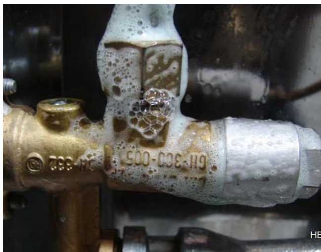
De oorzaak van de minieme lekkage was een ondichte koppeling onder het gasstel.
