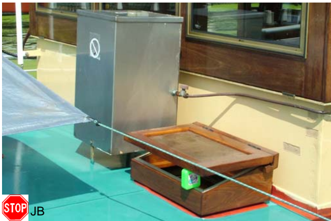
Ook hier staat de gaskast te dicht bij de opening.
