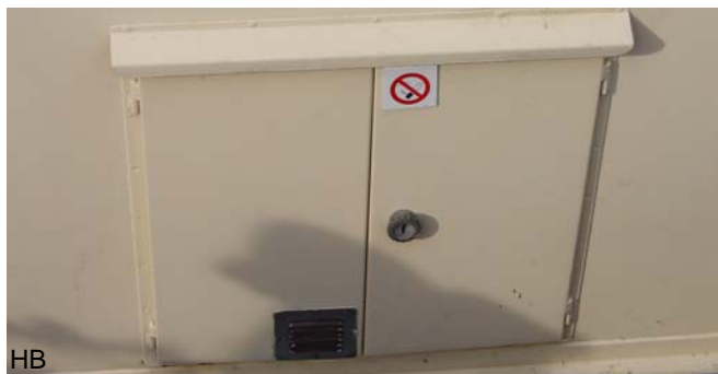
Een gaskast of flessenkast is een bergruimte voor gasflessen boven het dek.
