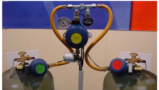
Als het een eenvoudige gasinstallatie is kan er gekozen worden voor een reduceer op de fles. Zijn er zware reduceren of veel gas nodig dan is het verstandiger om het reduceer op de wand te monteren. Dit om een te grote belasting op de fleskraan te voorkomen.
