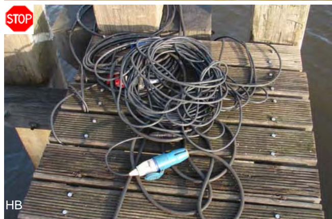
HB Vier situaties die we niet zo fijn vinden. Op de onderste stond er nog spanning op de verlengsnoeren!
