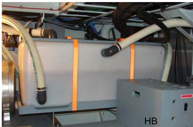
Een vuilwatertank die is ingebouwd door de werf in een schip dat voldoet aan de eisen van de Wet Pleziervaartuigen
