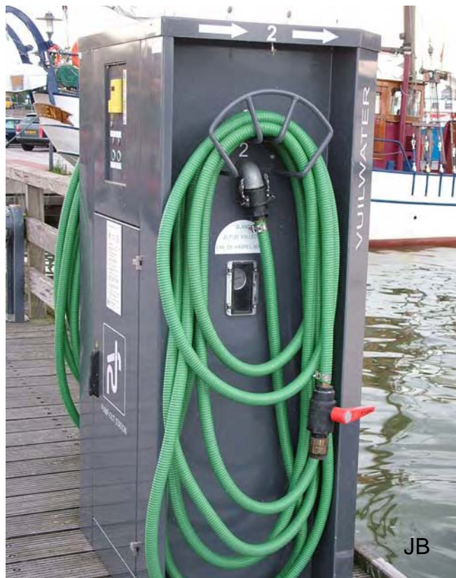
Een uitpompstation op de Gependam in Enkhuzen
