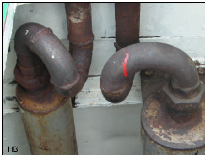
HB Bij deze uitlaten is er gevaar van CO lekkage en door de bochten is de tegendruk onnodig hoog.
