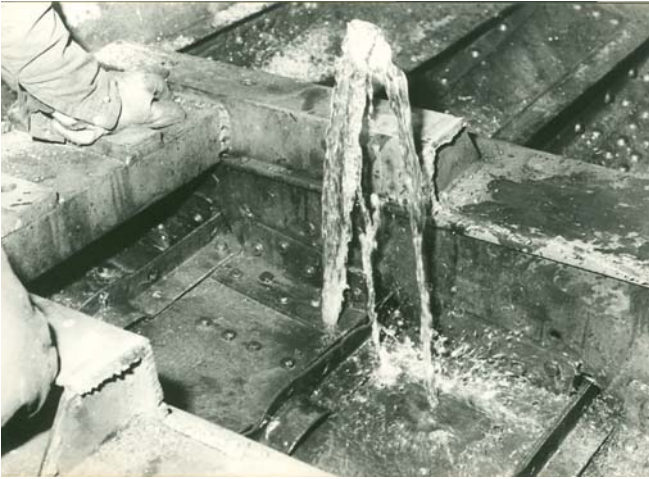
Af en toe springt er een klinknagel in het vlak en dan heb je een fontein van water binnen (EC)
