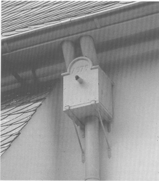
22. Goed voorbeeld van een veilig beloopbare goot met een doorlopende ondersteunende deel. De goot heeft het rek- of broekstuk boven de vergaarbak met 2 uitlopen. De vergaarbak is goed ondersteund en heeft een 'verklikker'. De hemelwaterafvoer is vrij van de muur gehouden, zodat lekkages niet direct op het gepleisterde muurwerk schadelijk inwerken.
