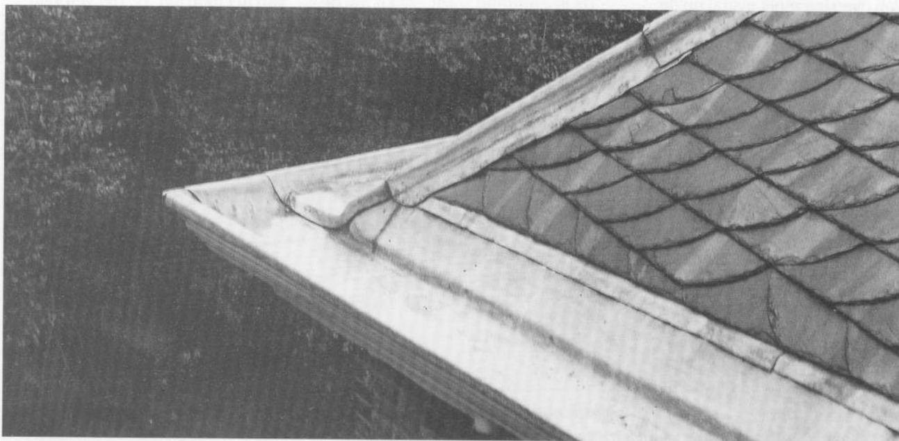
33. Voorbeeld van een goed geconstrueerde loden bakgoot, schuine opstanden en in verband met een verval op de hoek.
