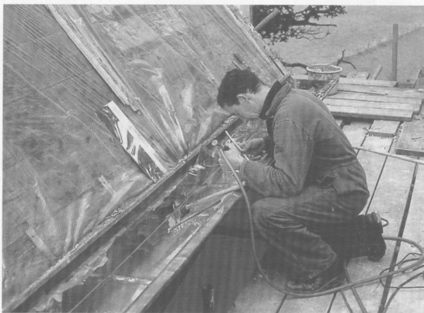
29. Het op de juiste wijze solderen of lassen bepaalt de levensduur van de koperen goot. Alleen vrijdragende mastgoten kunnen gelast worden.
