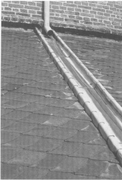
7. Een leigoot die ingedekt is in het flauwhellende dak van een zijbeuk om te voorkomen dat druiwater onder de leien doorslaat.
