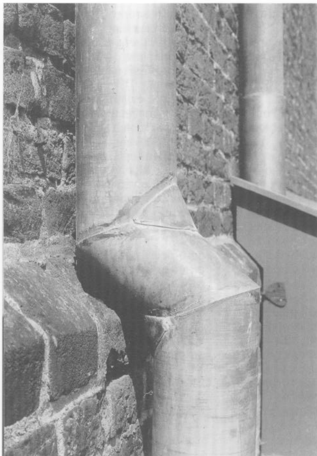
27. Zinken hemelwaterafvoer STZ-14. Opgezette stukken ter versterking van de sprong. In het algemeen leveren deze sprongen een sterk verhoogd risico voor verstoppingen. Ook het ontstoppen gaat daardoor vaak erg moeizaam.
