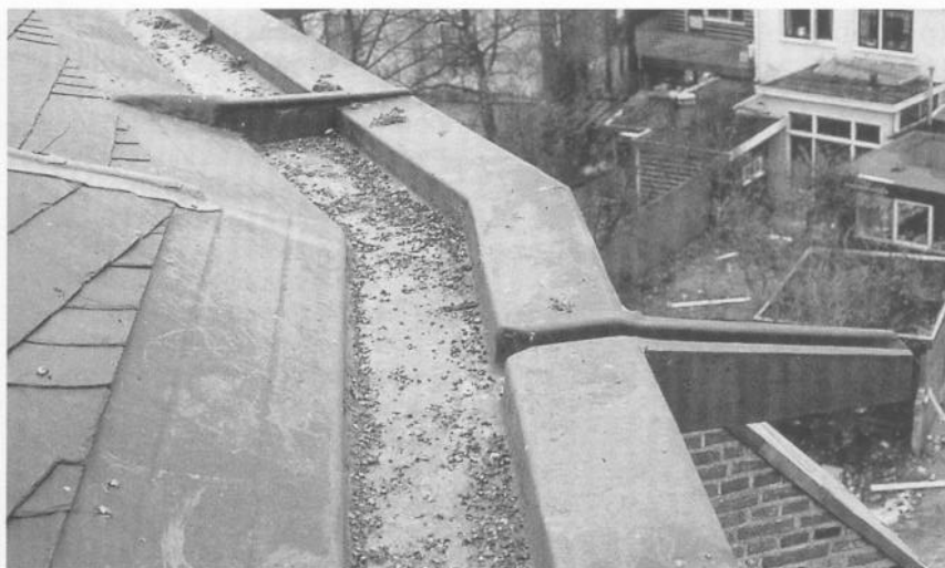
44. Een in het werk gemaakte polyester goot van een kooromgang, waarin op de hoeken scheurvorming optreedt.
