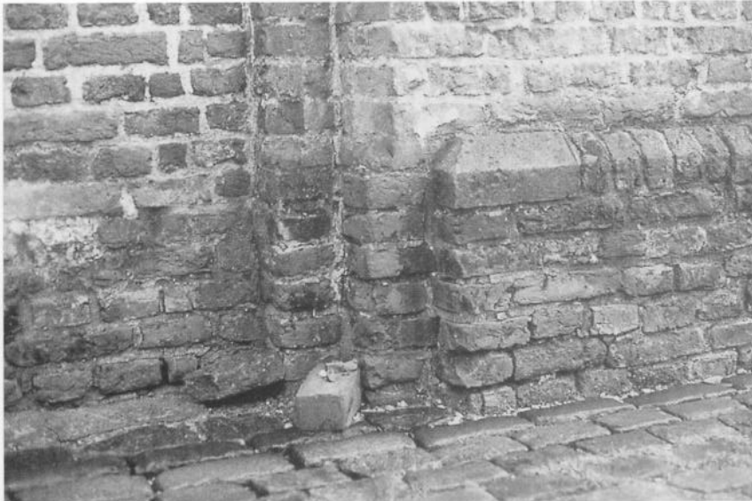
2. Schade door opspattend water als gevolg van het ontbreken van goten, grind of gras.
