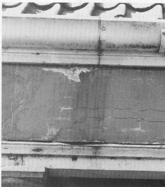
43. Een lekkende naad in een gietijzeren goot met moffen. De gevolgen voor het onderliggende pleisterwerk zijn duidelijk te zien.
