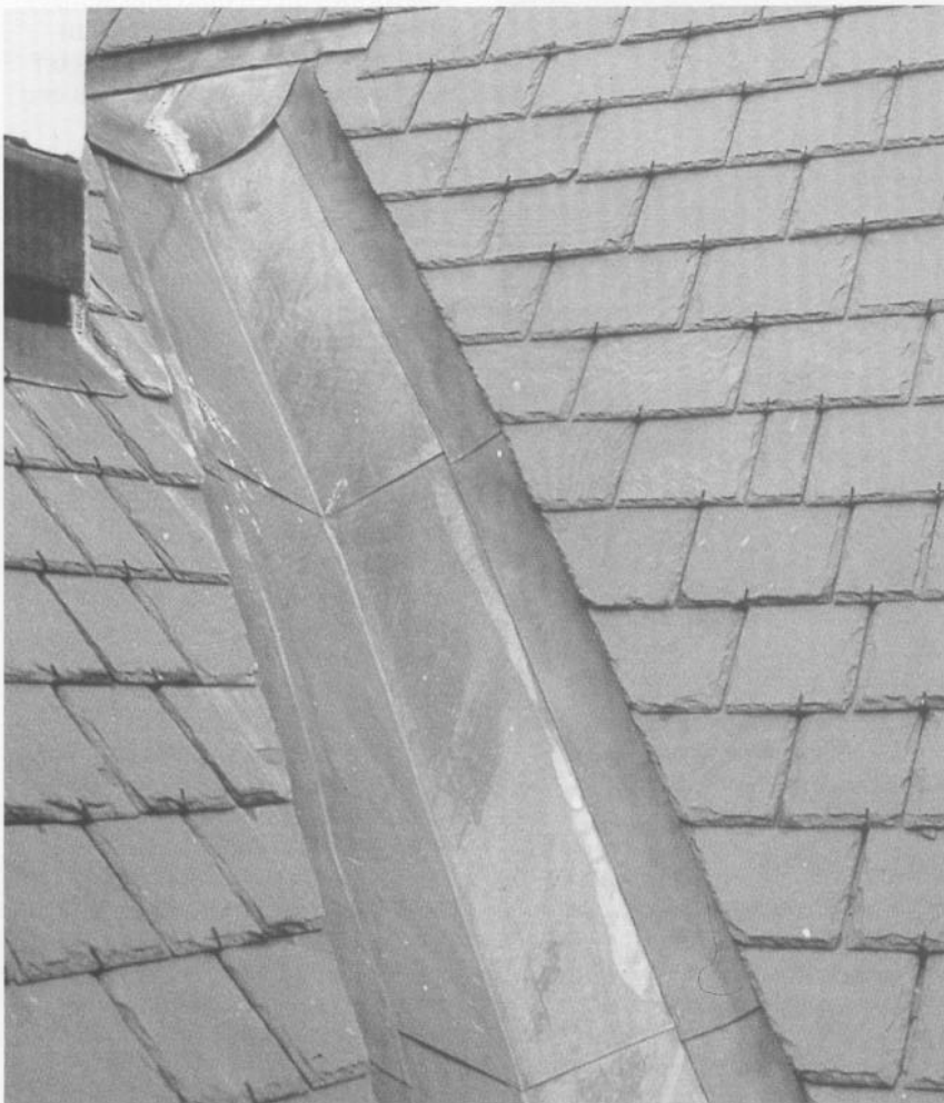
16. Een verdiept aangebrachte kilgoot in leibedekking, keurig afgewerkt met stroken killood in meterstukken.
