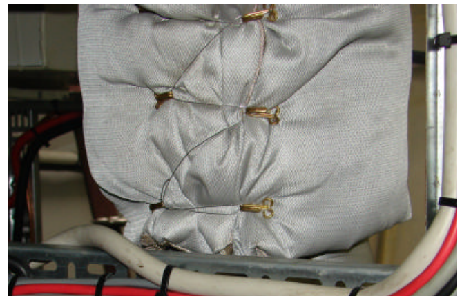
Het hele systeem kan worden geïsoleerd met matrassen.
