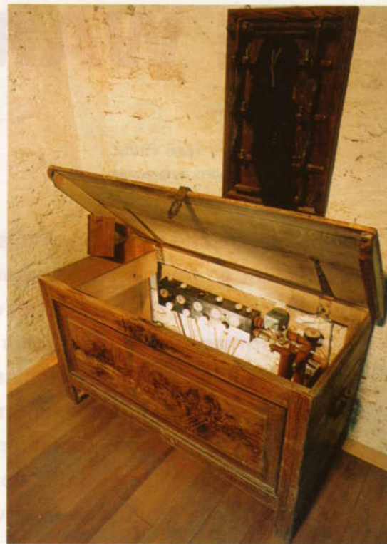
De regelapparatuur van het warmtepompsysteem wordt in een oude boekenkist aan het oog onttrokken.
